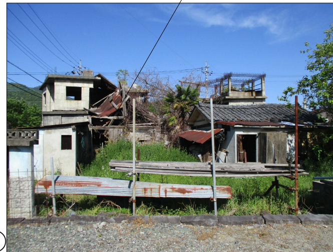
屋根崩落箇所
